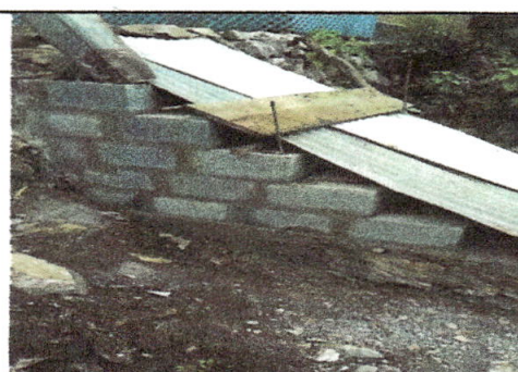
Foto 6: Continuación de gradas del establecimiento.
